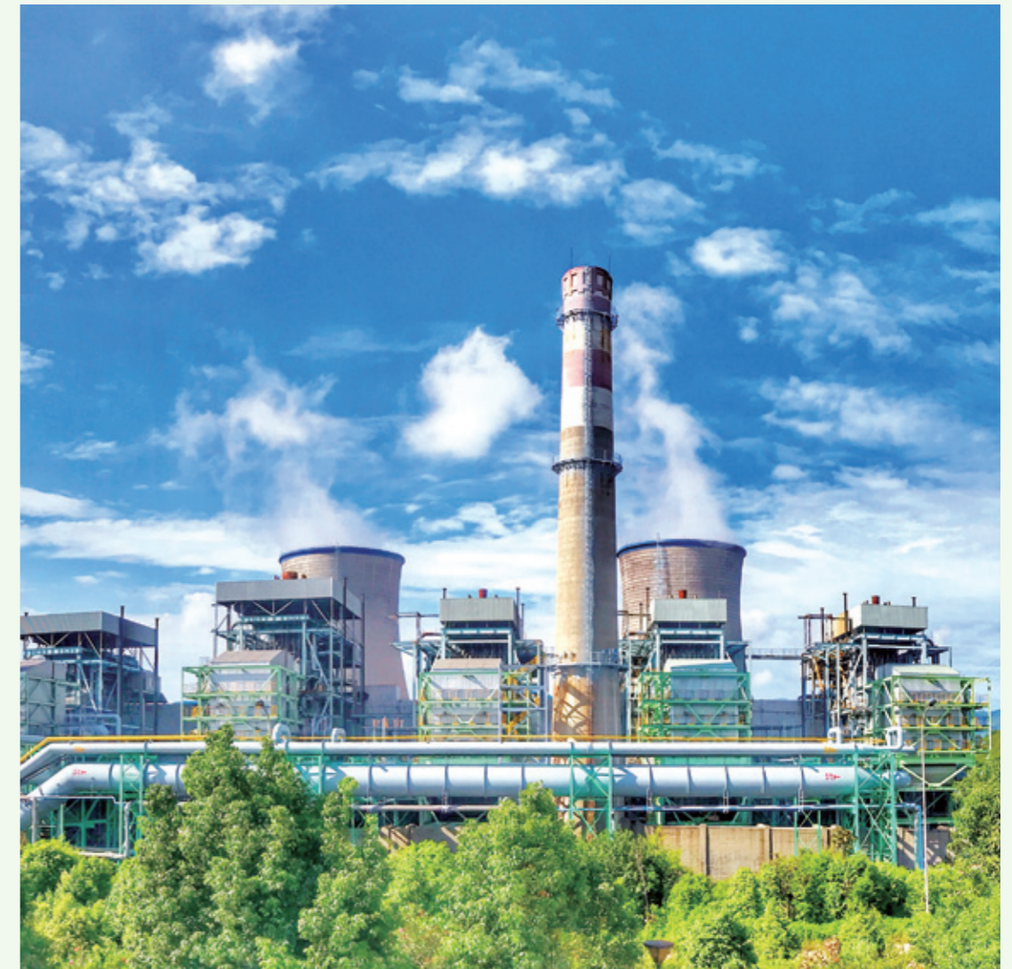
西昌钢铁发电脱硝系统
