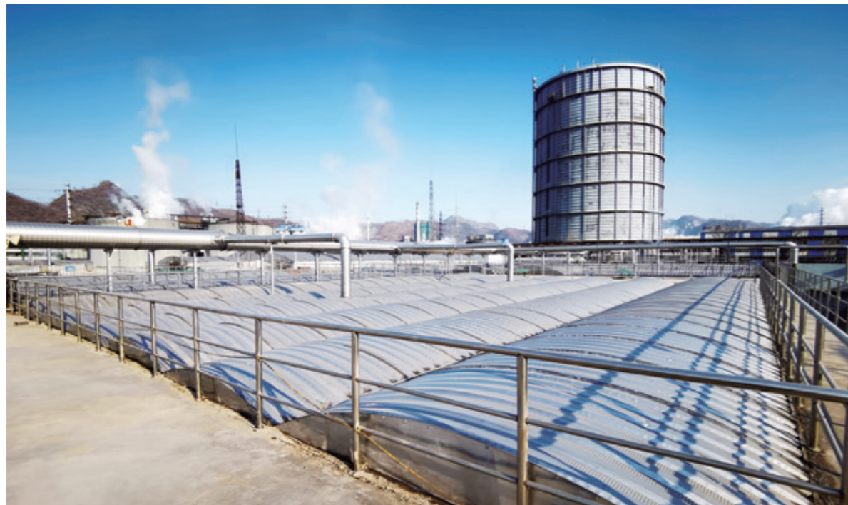
北营焦化酚氰废水处理站气味治理设施
