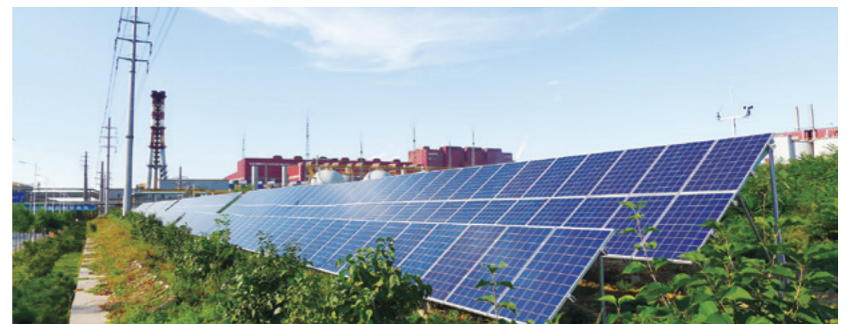
太阳能光伏发电
